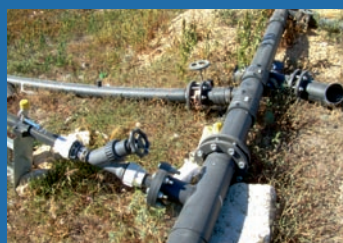
Vannes et raccords
