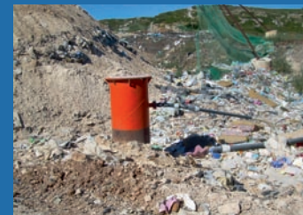
Tête provisoire de puits biogaz
